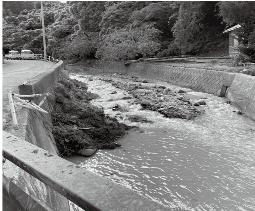
流木・土砂が撤去された藤島川の様子
