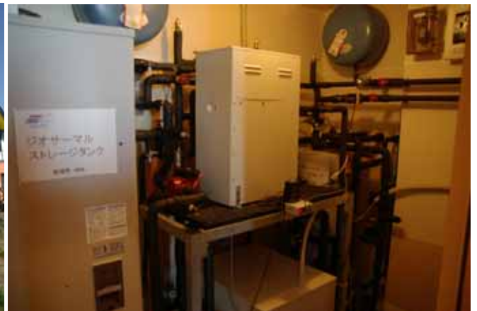
エコ住宅 ヒートポンプ
